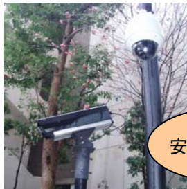
防犯カメラ設置
