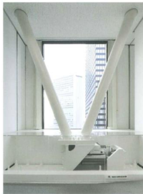
新宿センタービル「軸力制御オイルダンパー」
