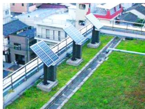
オリナスタワー（太陽光パネル）
