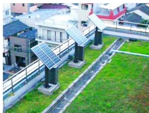
オリナスタワー（太陽光パネル）
