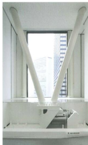
新宿センタービル「軸力制御オイルダンパー」
