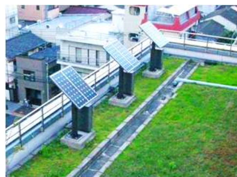
オリナスタワー（太陽光パネル）
